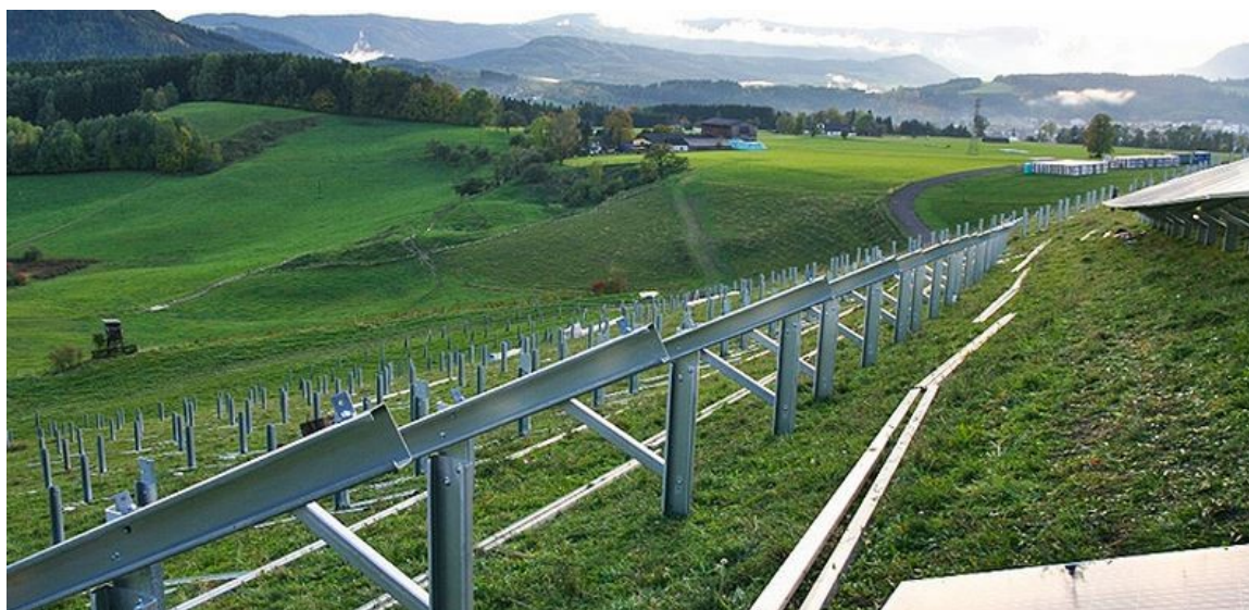
Zdjęcie 3. Konstrukcja przeznaczona do posadowienia paneli fotowoltaicznych.
